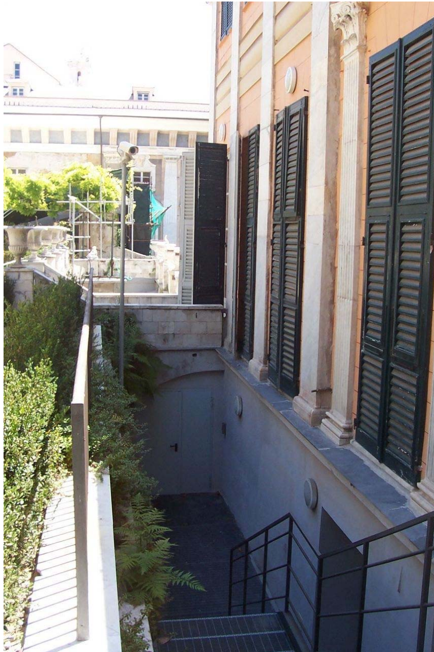
2.11. FOTO 11 : Scorcio del Fronte NORD di Palazzo BIANCO con l'attuale scala di sicurezza dal Livello 02 (Tessilteca) al giardino.
