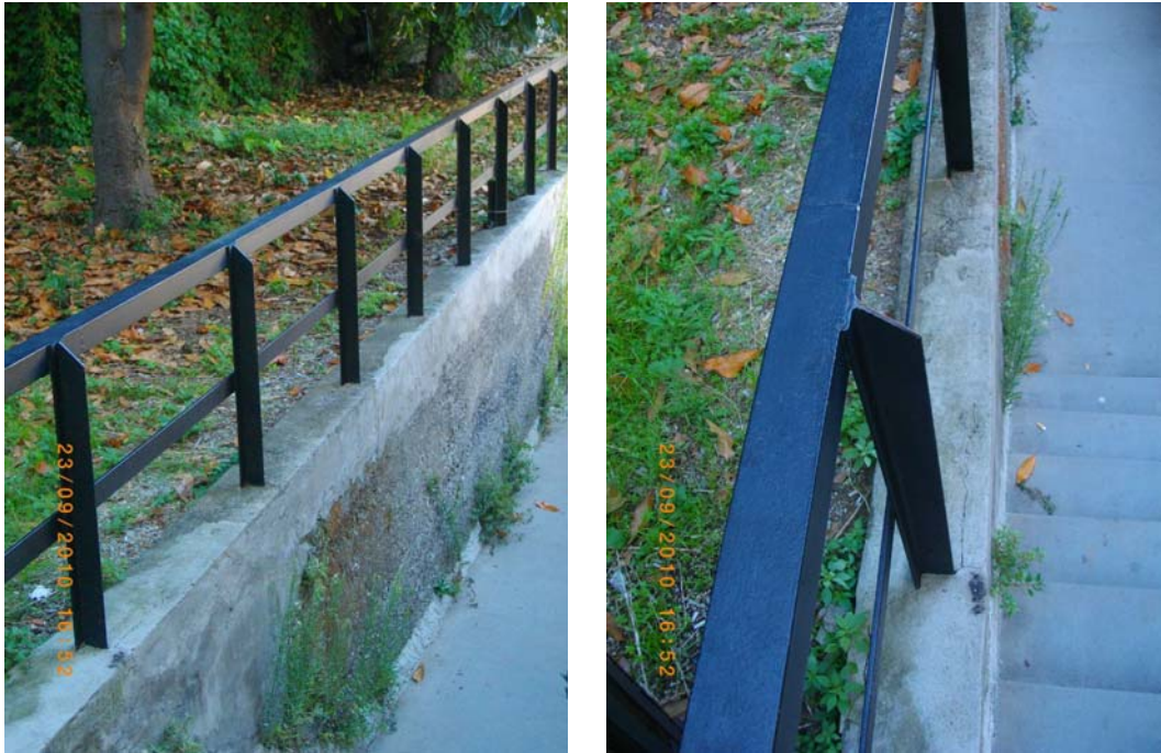
FOTO 13- 14 : Retro Palazzo “Galliera” (Interventi B1-B2-C) – Ringhiera
