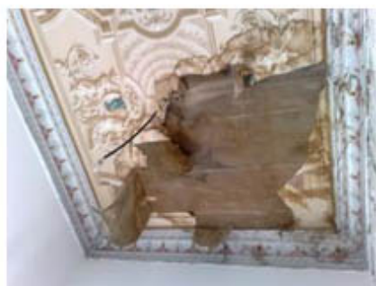
Il soffitto del palazzo stucchi e affreschi danneggiati
