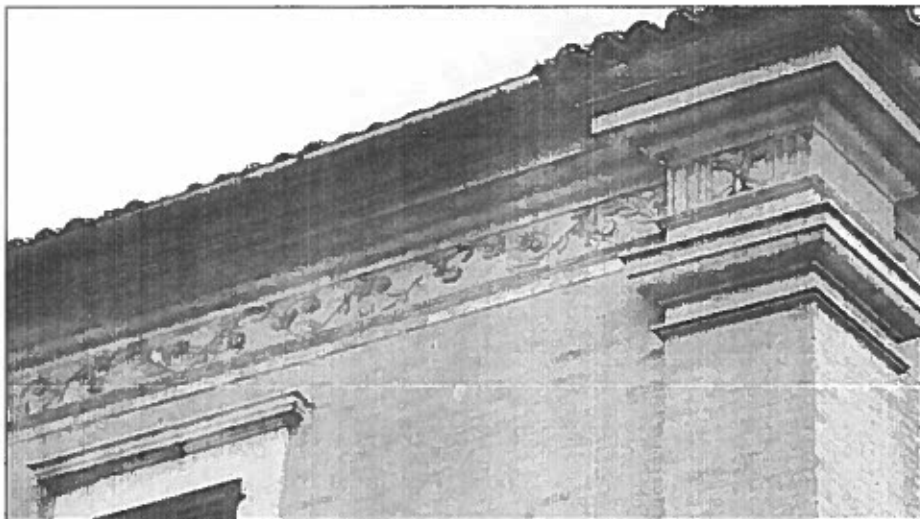
09) Muratura in mattoni a vista; cornicione intonacato e decorato a stucco bianco.
